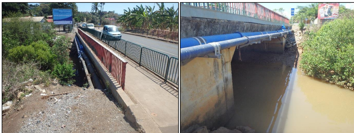
Figure 45 : Ouvrage de franchissement de la RN2 au droit de l'exutoire en mer
