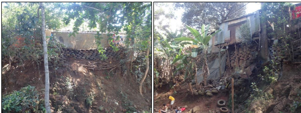
Figure 39 : Talus stabilisé au moyen de pneus.
