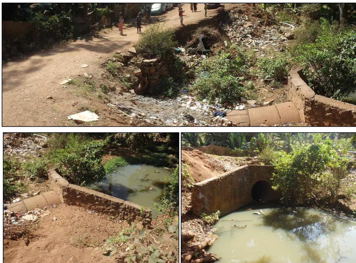
Figure 43 : Ouvrage busé dégradé sous l'action des submersions successives.
