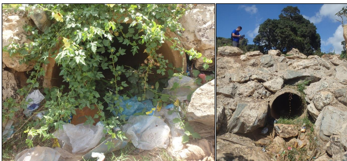
Figure 46 : Ouvrage busé partiellement comblé permettant la transparence hydraulique
