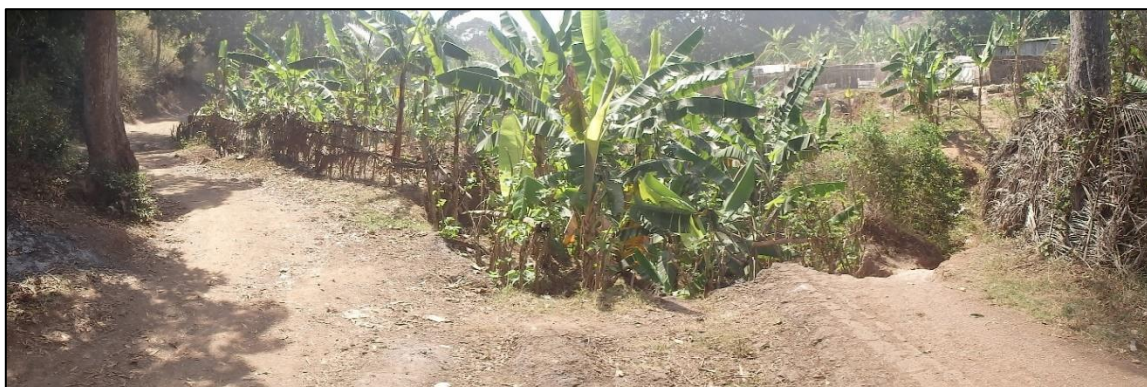
Figure 31 : Ouvrage de franchissement détruit lors d'une précédente crue
