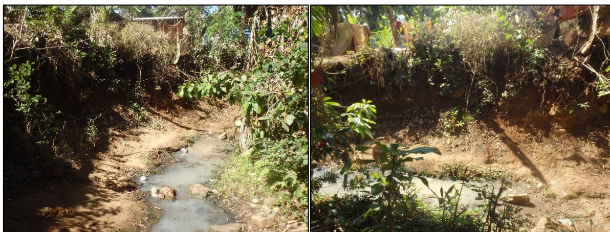
Figure 28 : Phénomènes érosifs observés en partie médiane
